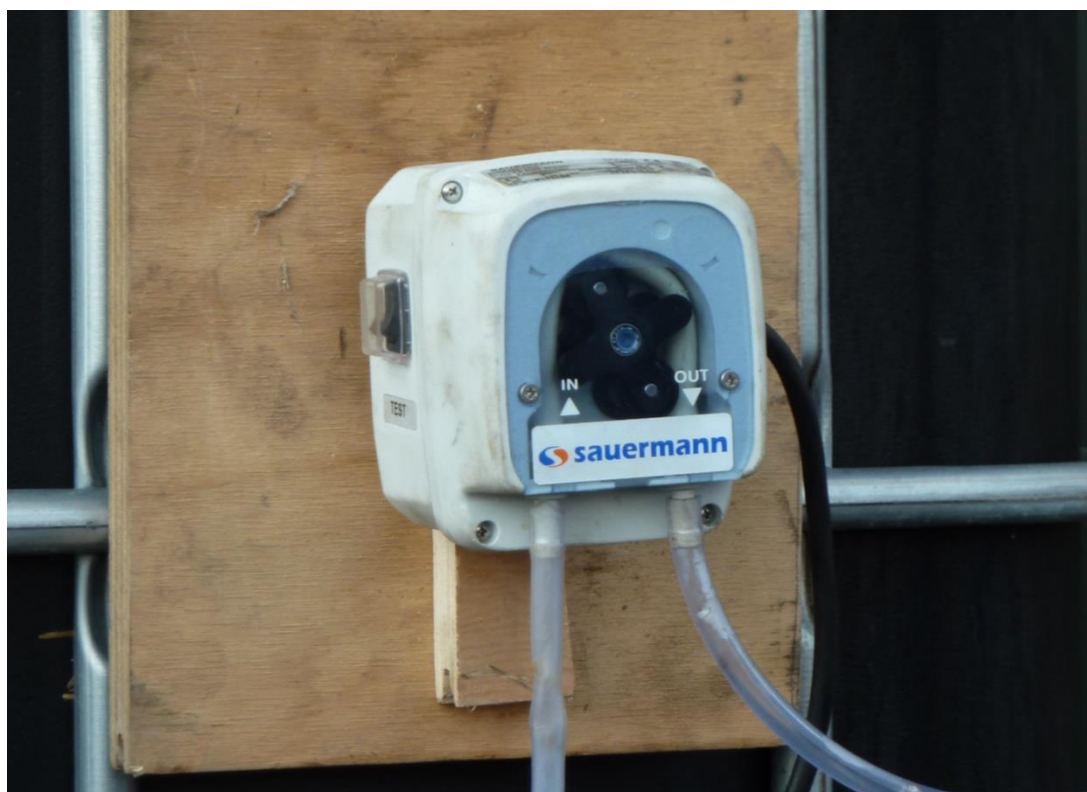
Rys. 45. Niskoprzepływowa pompa perystaltyczna w obiegu odcieków ze stanowiska BIOFILTER
