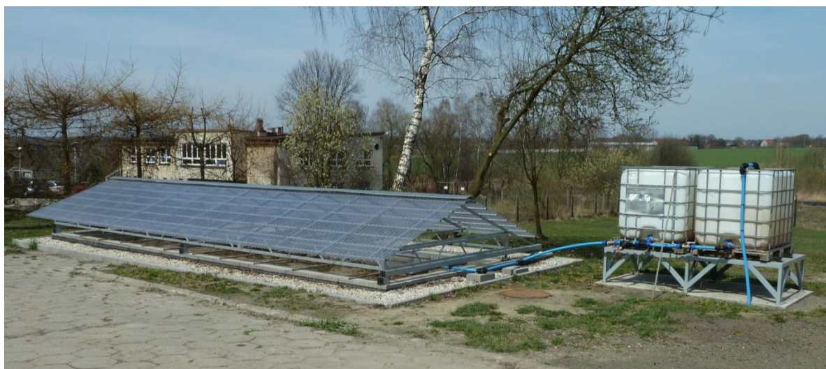
Rys. 12. Podniesione zbiorniki buforowe z grawitacyjnym spływem pozostałości do stanowiska bioremediacyjnego
